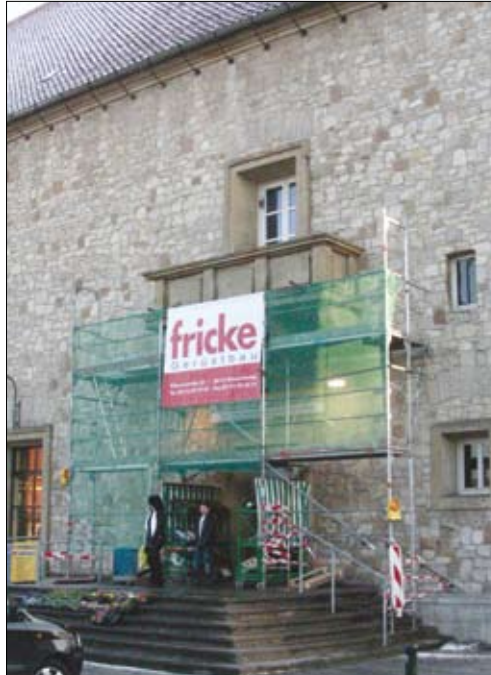
Der Eingangsbereich des Görge-Marktes im Roxy ist bis auf weiteres durch ein Gerüst vor Steinschlag geschützt.
